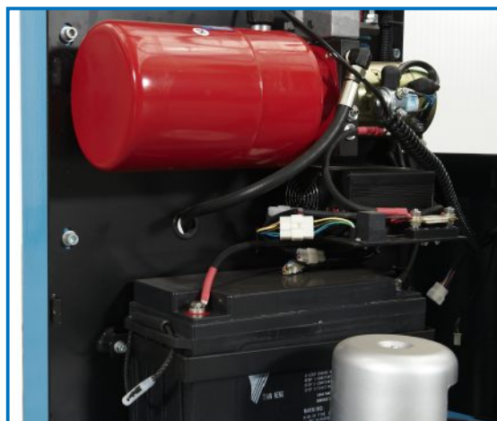
Eine klare Gliederung und übersichtliche Anordnung der Baugruppen vereinfacht die Wartung der E-SDJ.
