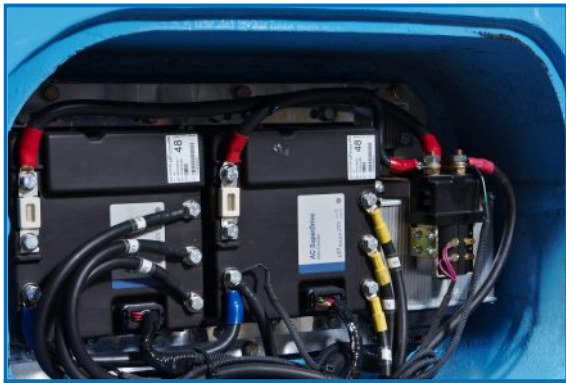
Die DANAHER AC-Controller sind im Heck angebracht und über ein CAN-BUS-System verbunden.
